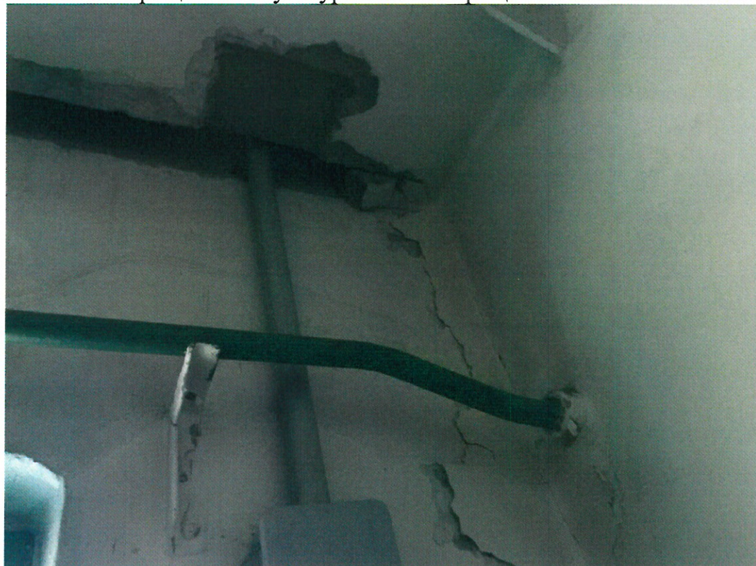
Фото П2.6 – Разрушение межпанельных швов. Трещина в штукатурном слое
