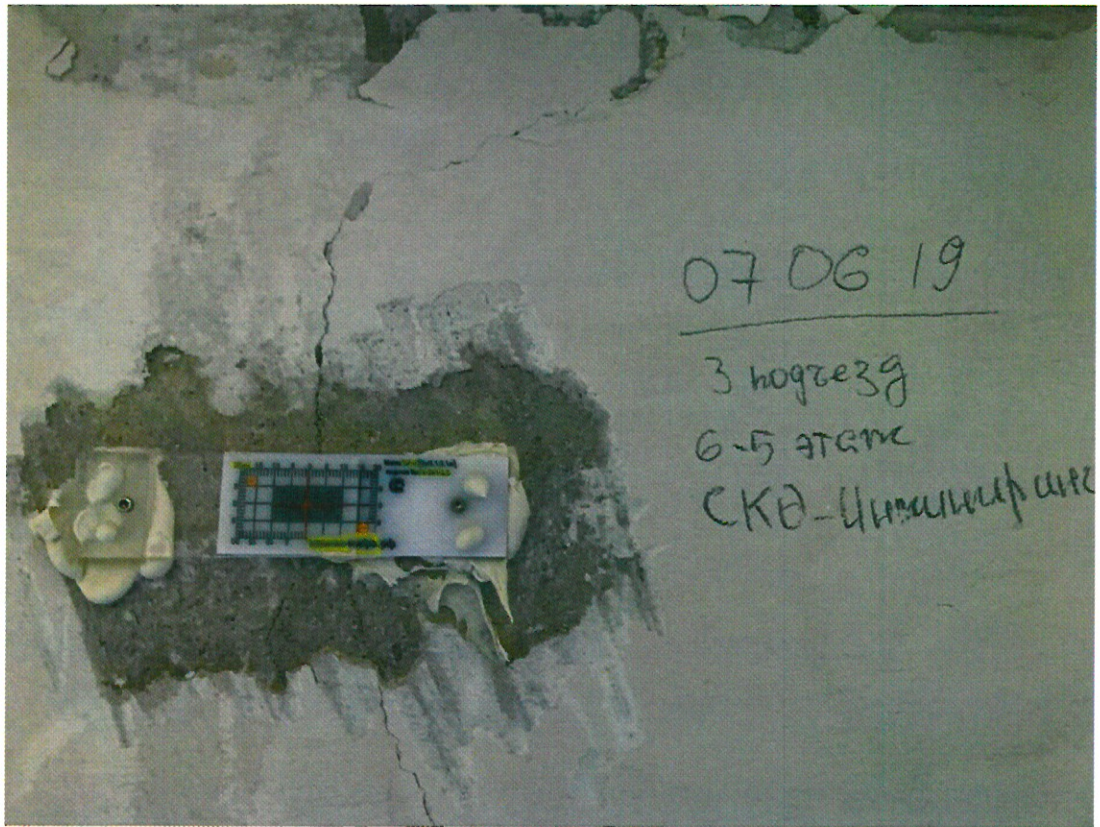
Фото П2.8 – Установка маяка в здании на ул. Северная Застава, д.5 (3 подъезд, между 5 и 6 эт.). Трещина в поверхностном бетонном слое стеновой панели
